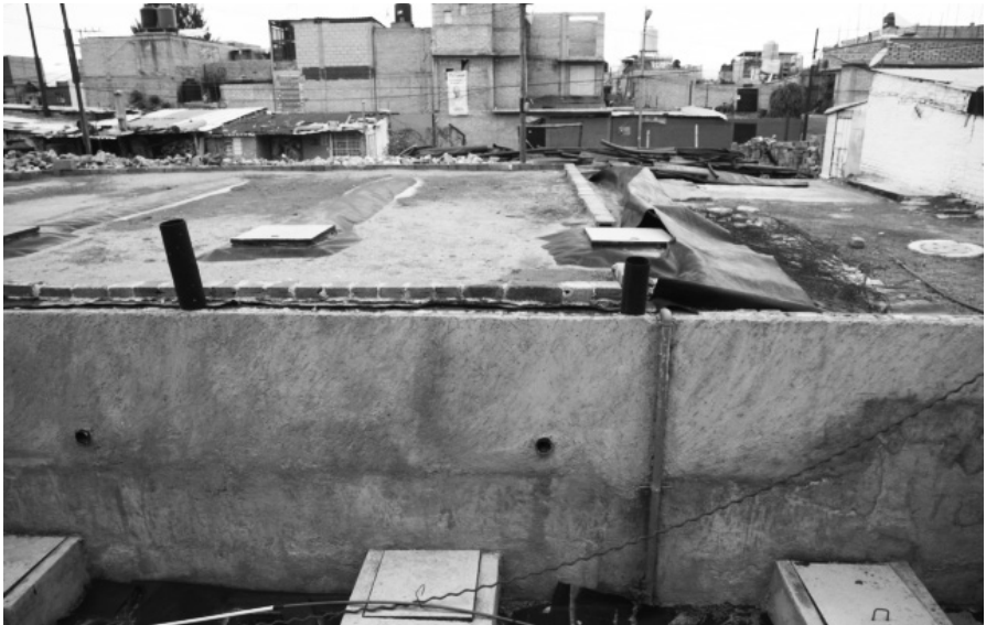
Sistema di raccolta delle acque piovane di Acapatzingo.
